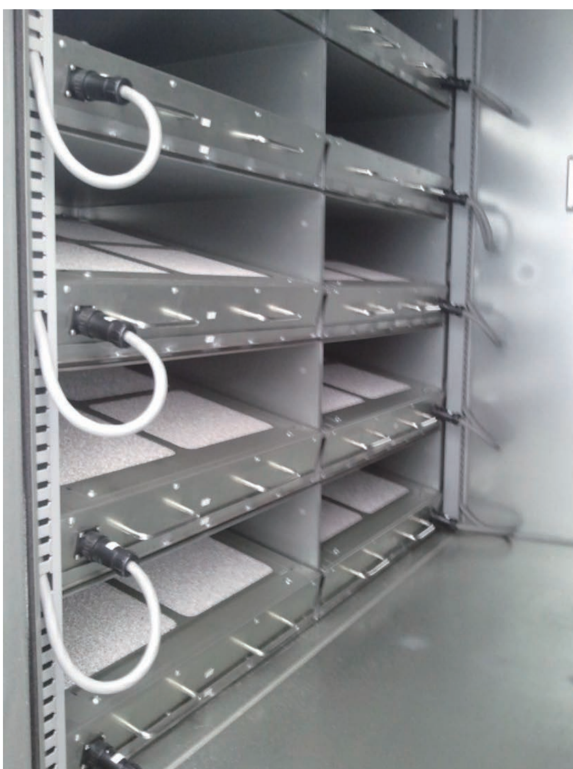
▲内部・メンテナンススペース
